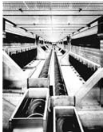
Abb. 1.5: Wendelförderer in der Entsorgungswirtschaft
